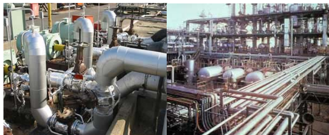
プラント配管設備
