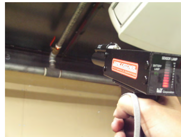
エア漏れ診断
